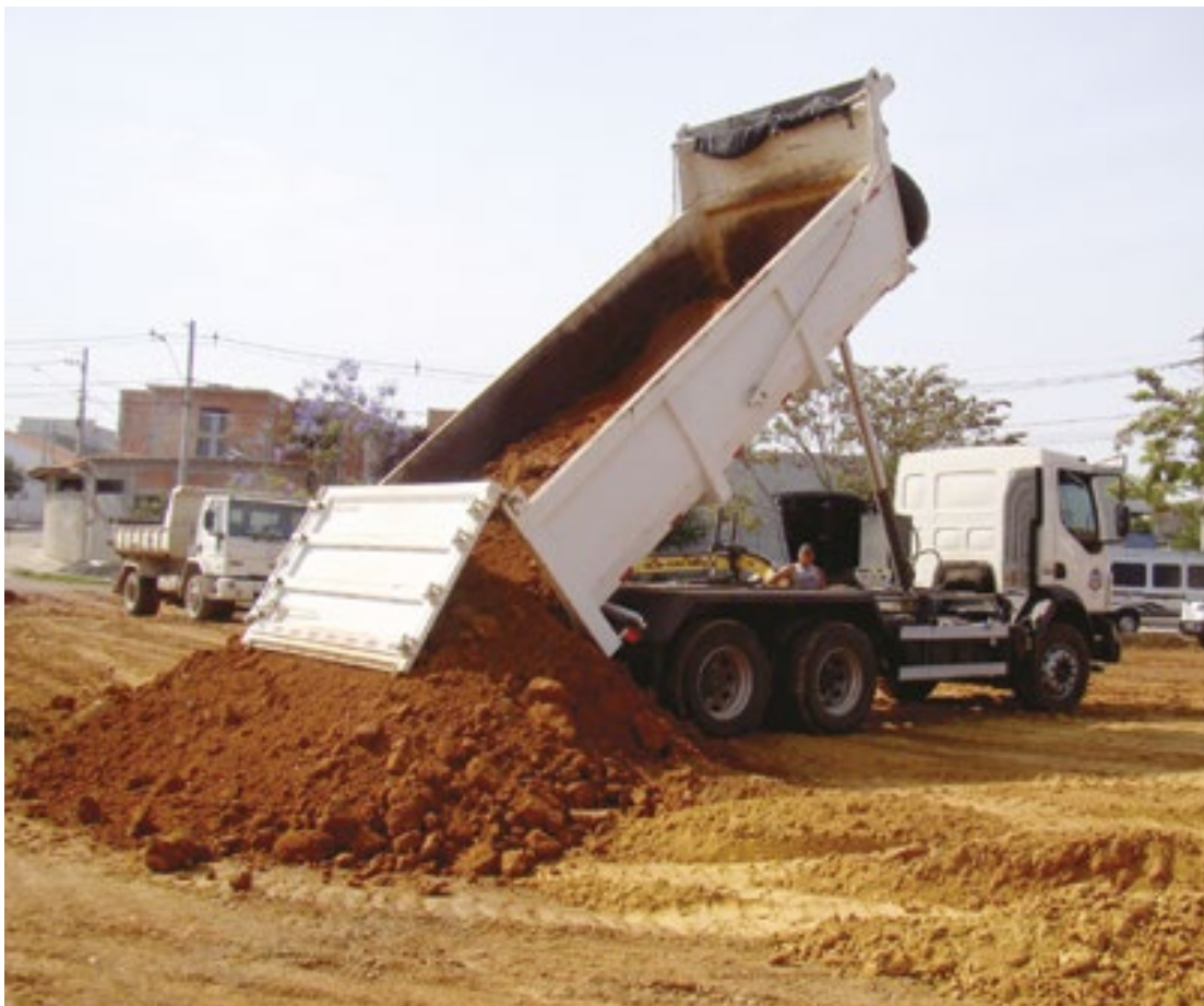
Na última semana as equipes iniciaram os trabalhos de limpeza e aterramento da área externa
